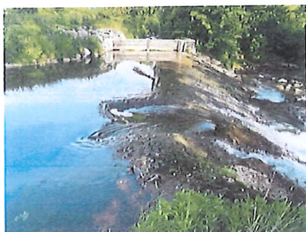
Echancrure dans la digue de retenue
